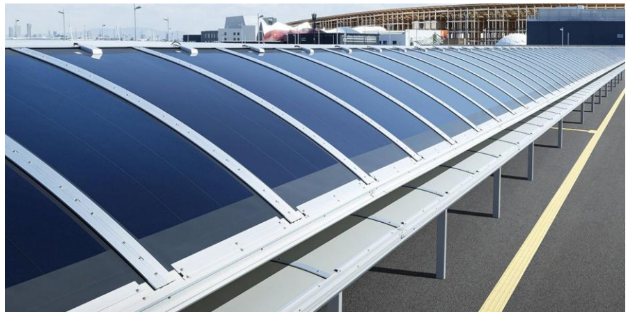
万博内バスターミナルに設置されている積水化学のフィルム型ペロプスカイト太陽電池
