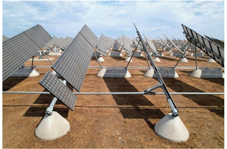
米カリフォルニア州に設置されたソーラーパネル＝ロイター
