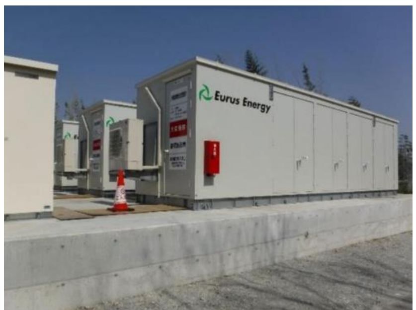
ユーラス白鳥バッテリーパークの系統用蓄電システム（出所：ダイヘン）
