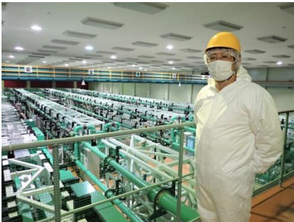
レーザー科学研究所内のレーザー装置の配管と藤岡氏 (写真: 日経クロステック)
