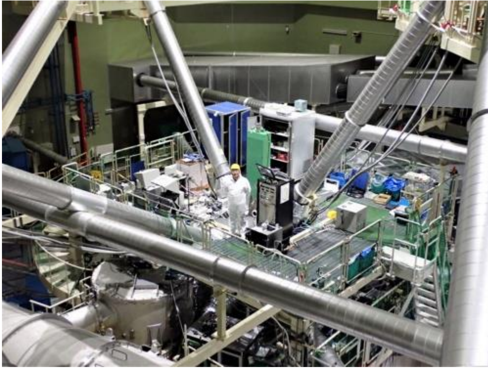
藤岡氏(中央)の真下に核融合炉があり、レーザーの配管が集中する(写真:日経クロステック)
