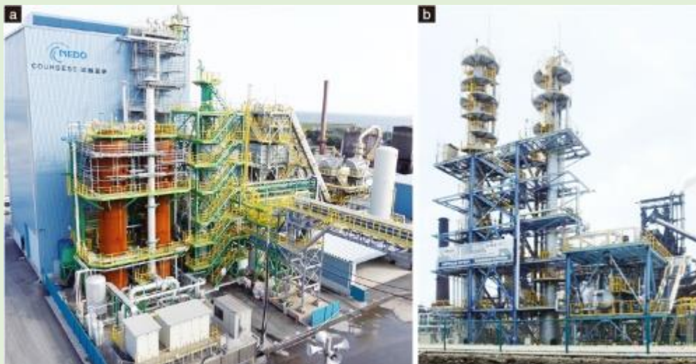
図1 COURSE50の小型試験高炉
